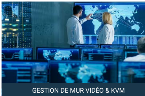
Salles de contrôle
